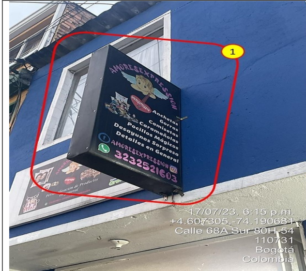
Elemento de PEV del establecimiento comercial, el cual se encuentra volado de la fachada de la edificación.
